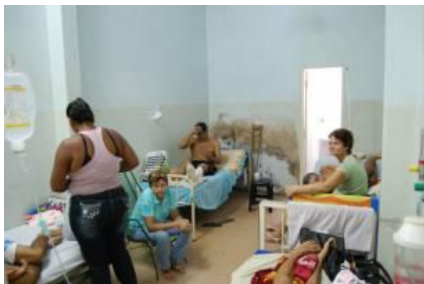
Pronto-Socorro de Várzea Grande em péssimas condições
